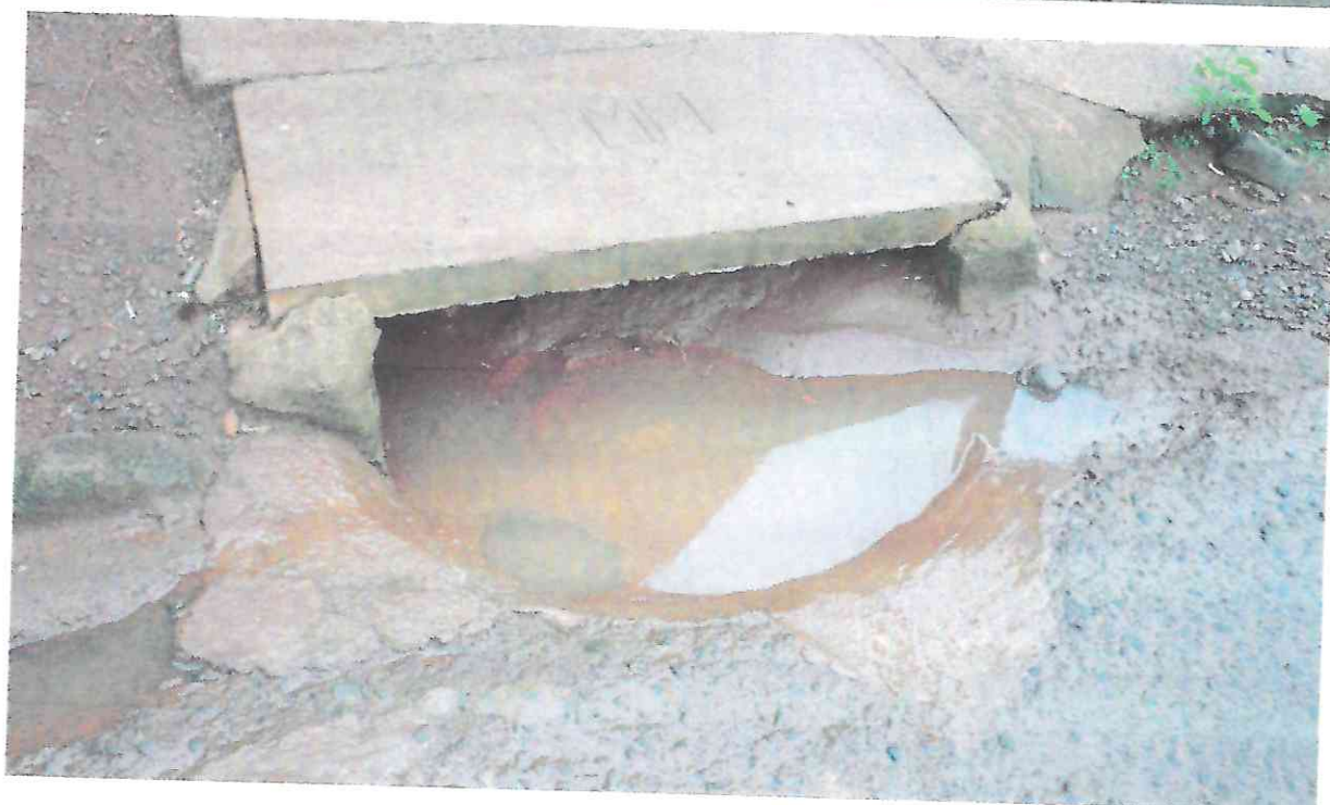
Desentupimento dos bueiros Tampar os buracos Rua Matsuko Mertz Jd Irma
