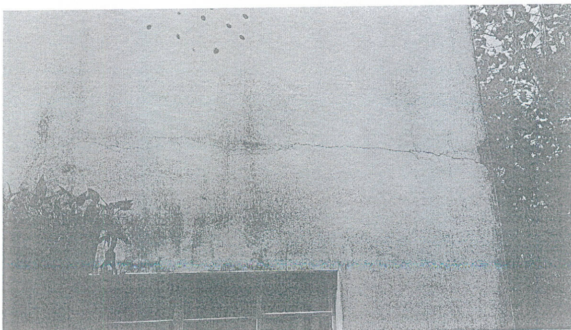
Figura 7 - Fissura em parede externa de apartamentos
