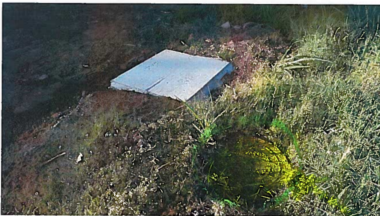
Foto 02 – Tampa de ferro de Poço de visita – Rua Pau Brasil x Rua Cedro
