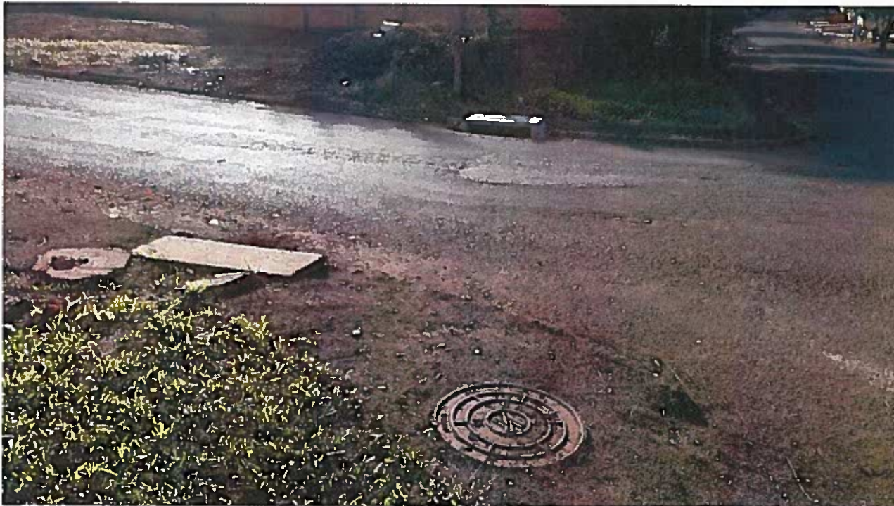
Foto 01 – Tampa de ferro de Poço de visita – Rua Pau Brasil x Rua Cedro
