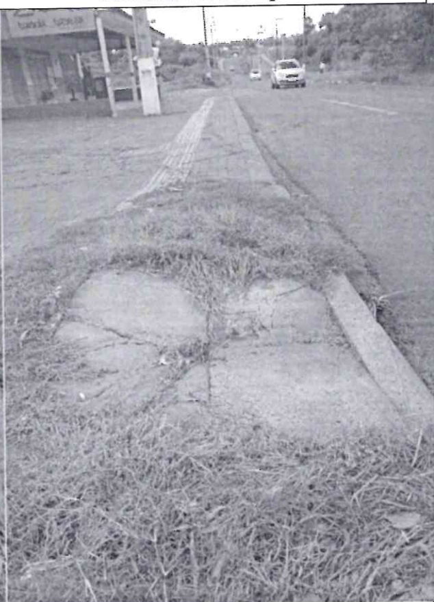
BUEIRO 3 - Av Andradina Prox a borracharia da esquina
