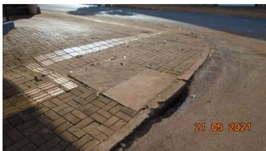
Figura 17 – Recomposição de calçada e BLS danificadas na execução da drenagem (Rua Pilar esquina com Rua Sobradinho)
