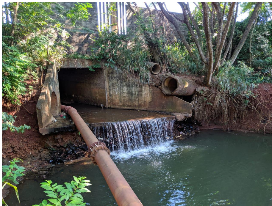
Figura 7 – Boca existente e erosão causada
