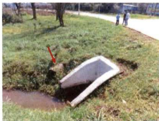
Figura 22 – Lançamento de efluentes coletados em boca de lobo da Av. Morenitas em vala de drenagem existente na Av. Mercosul.
