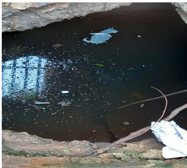
Foto 03: Água parada na Galeria Pluvial do Bairro
