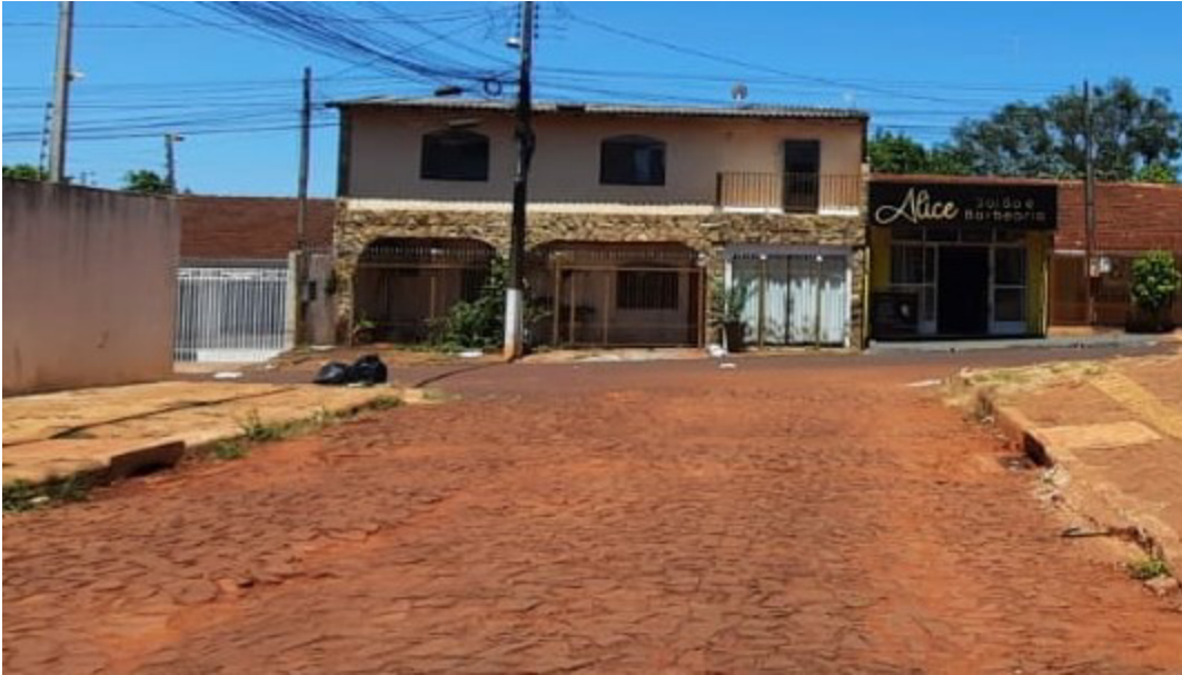
Figura 5 – Esquina da Rua Cantagalo com Rua Pilar, pavimento irregular e com solo
