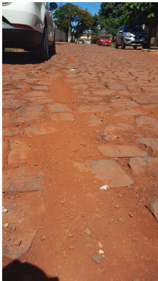
Figura 6 – Trecho de falha de pavimentação poliédrica, entre a recomposta e anterior
