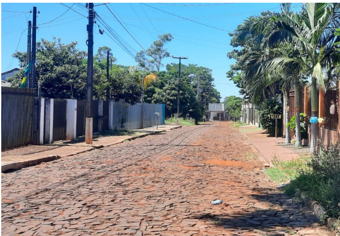
Figura 2 – Rua Jacanga, início da área de intervenção, com falhas na pavimentação
