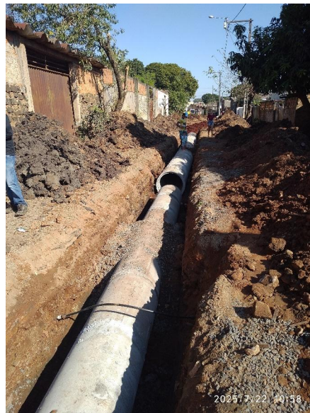
Imagem 6 – Mudança de diâmetro dos Tubos no trecho da Rua Rômulo Carbone
