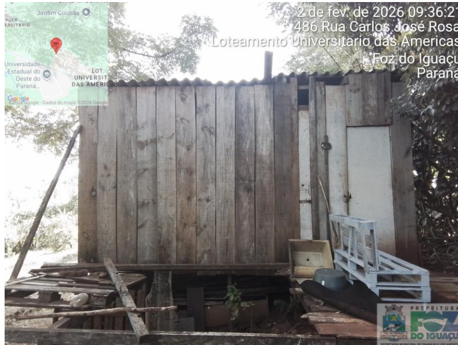
3 – Situação encontrada na vistoria do dia 02 fevereiro de 2026.
